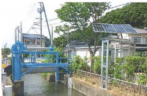
【自動化した会地排水門（坂城町）】
