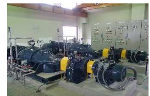
【整備した排水ポンプ設備】
