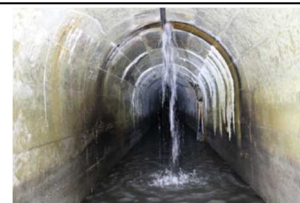
【補修が必要な水路トンネル】
