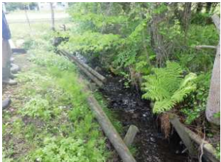
農業用水路の被害状況
