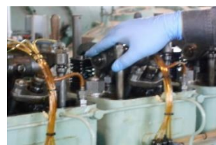
部品欠損し代用品で供用している原動機
