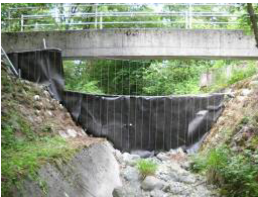
図 6 富士見町設置状況
