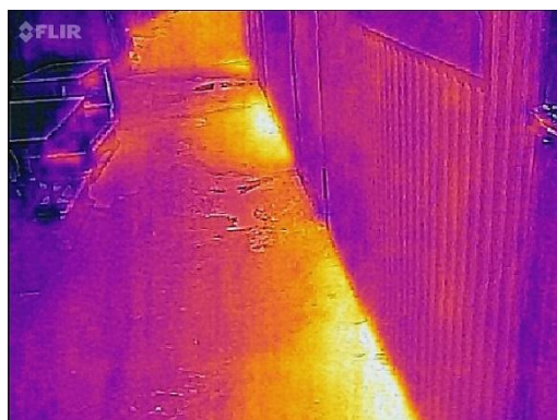
図3 室内からの熱漏れ
