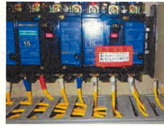
[揚水機場]ポンプ制御盤:更新
