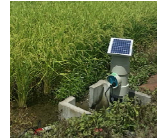
自動給水栓による 用水管理の省力化
