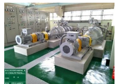
【整備したポンプ設備 （西寺尾第2排水機場）
