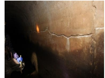
【芋川隧道の破損状況】
