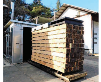
品質の確かな製材品を供給するための乾燥施設
