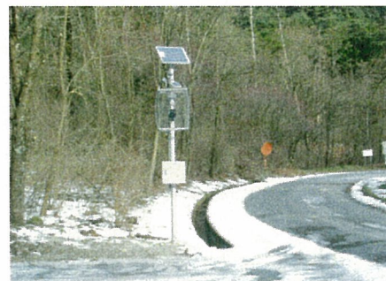
【およりの森駐車場設置写真】
