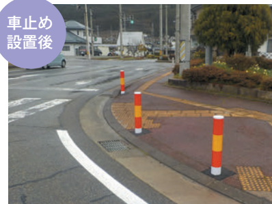
車止めポスト設置例
