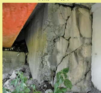
橋台のひび割れ
