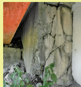
橋台のひび割れ
