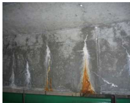
(2-4) 明石洞門（主梁） （縦方向に生じているもの）
