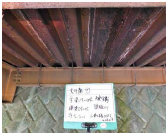
(2-2-1) 大川南スノーシェッド(腐食)
