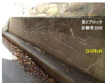
(2-2) おげんびし洞門（受台） （横方向に生じているもの）
