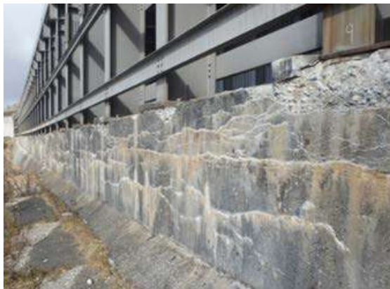
(1-4-1) 横ぞり 2 号スノーシェッド (ひびわれ)
