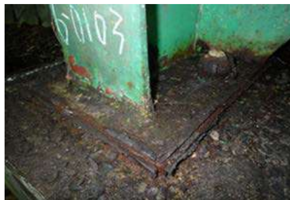
(2-4-2) 峠下1号スノーシェルター (腐食)
