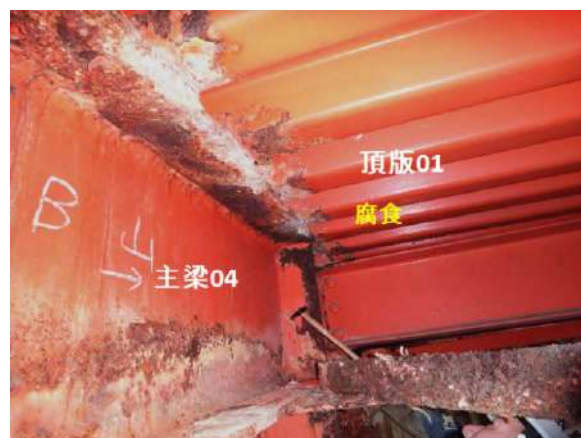
(2-2-2) 白沢スノーシェッド(腐食)
