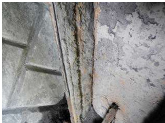
(2-3-1) 大川南スノーシェッド(腐食)
