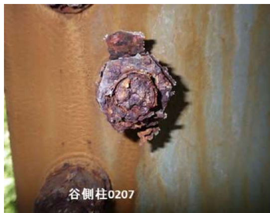
(2-3-2) 七倉11号スノーシェッド(腐食)
