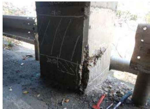
(1-3-2) 大日向ロックシェッド (うき、剥離・鉄筋露出)
