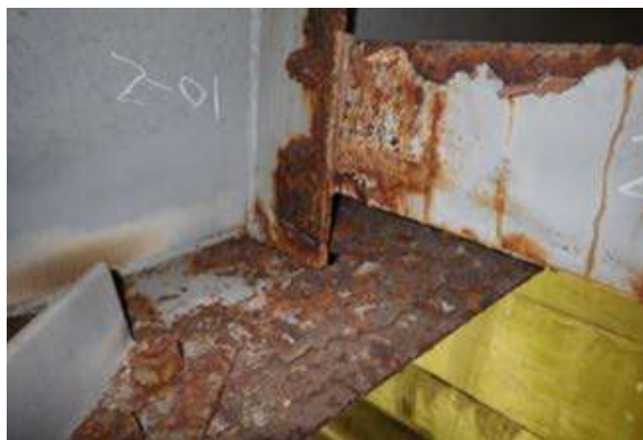
(2-1-1) 七倉 11 号スノーシェッド(腐食)
