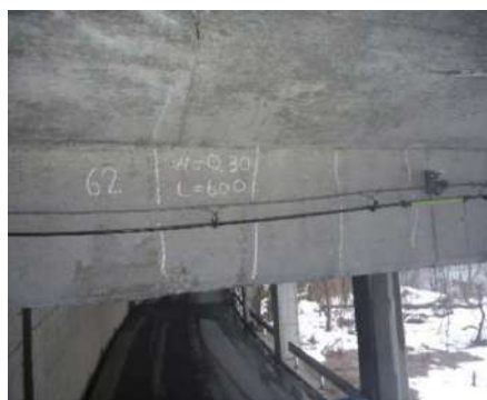
(2-1) 西大滝スノーシェッド（主梁） （縦方向に生じているもの）
