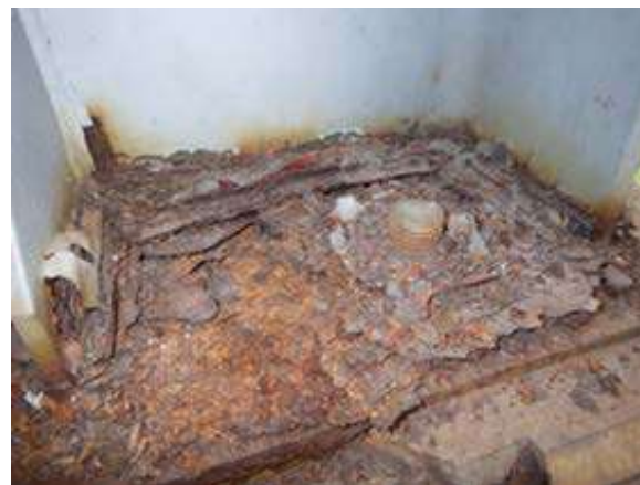
(2-4-4) 七倉11号スノーシェッド (腐食)
