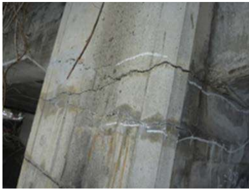
(1-3-1) 西大滝スノーシェッド (ひびわれ)
