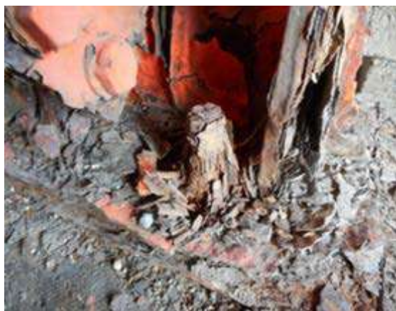
(2-4-3) 雪坪スノーシェッド (腐食)
