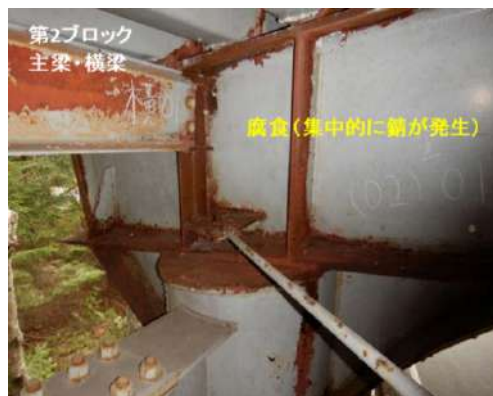
(2-1-2) 七倉 13 号スノーシェッド(腐食)
