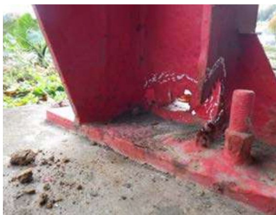
(2-3-3) 清水河原スノーシェッド(腐食)
