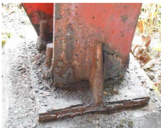
(2-4-1) 雪坪スノーシェッド (腐食)
