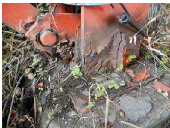
(2-3-4) 雪坪スノーシェッド(腐食)
