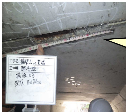
主桁損傷状況 (判定区分Ⅲ)
