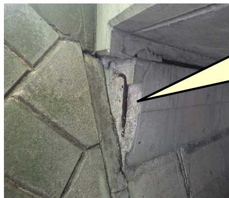
橋台損傷状況 (判定区分Ⅲ)
