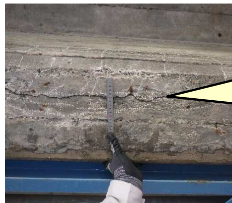
主桁損傷状況 (判定区分Ⅲ)
