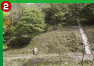
張石水路(悪沢合流点上) 斜面の上部まで真っ直ぐに作られています。【明治末施工】
