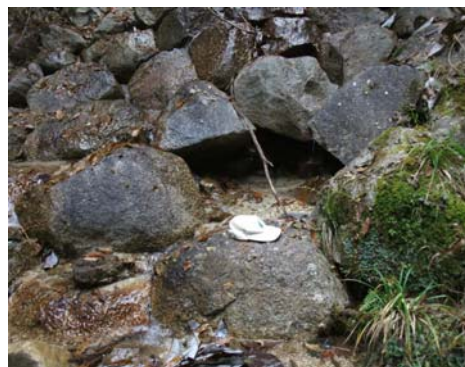
写真 13 境沢第 1 堰堤の欠落
