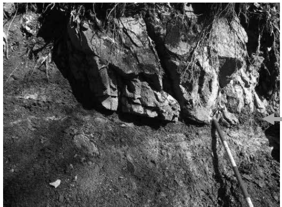
写真 4.2.7 悪-6 堰堤左岸の断層破碎帯
