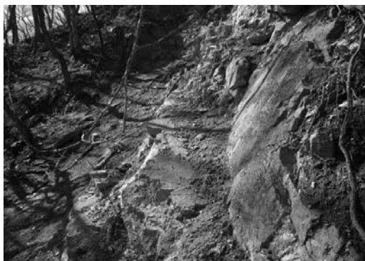
写真4.2.1 崩壊地の状況
