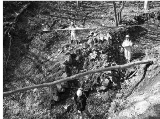
写真 4.2.5 悪-6 堰堤の左岸袖部が破損
