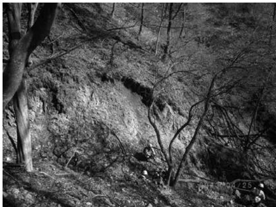
写真 4.2.6 悪-6 堰堤上流左岸の崩壊地
