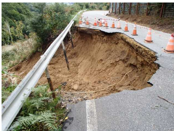
国道143号 会吉トンネル下 道路路肩崩落
