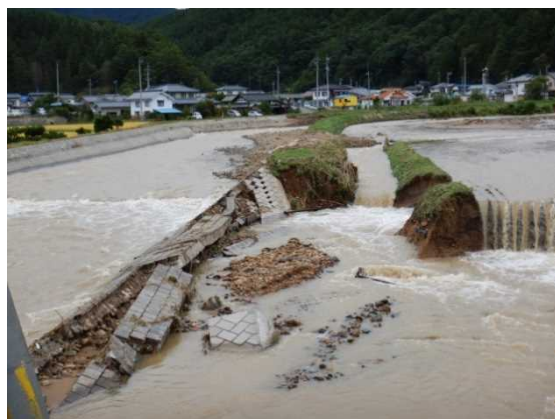
一級河川 麻績川 宮の下 河川護岸欠損
