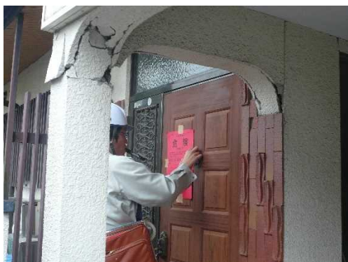
判定ステッカーで危険度が分かります！ (熊本地震での判定活動)
