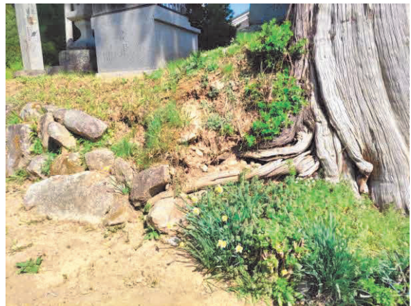
根元付近 根が石垣に入り込む (令和4年4月撮影)
