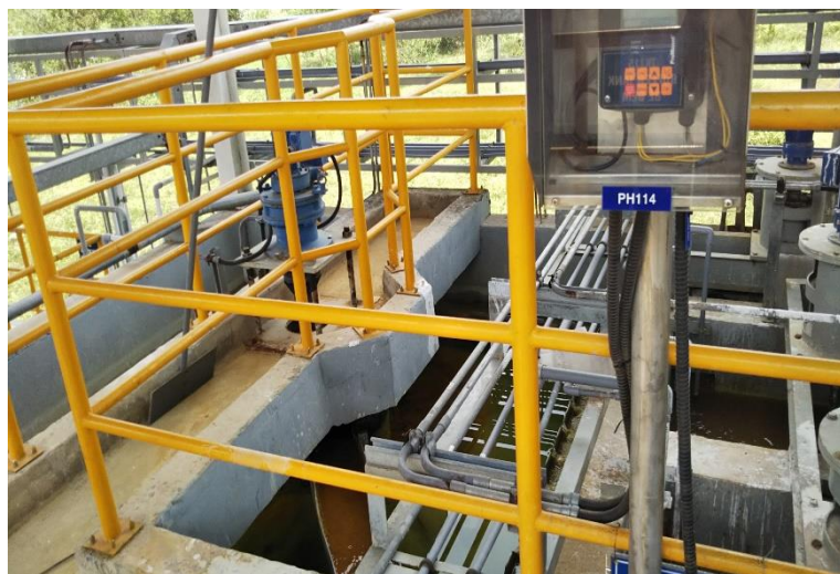
写真4 排水処理施設の様子
