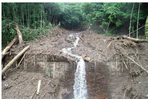
土石流で壊れながら土砂を受け止めた治山ダム（ドローンで撮影）
