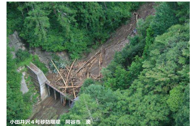
小田井沢4号砂防堰堤 岡谷市 湊
