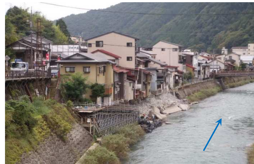
令和3年8月の大雨により護岸基礎が崩れ、護岸に沿って並ぶ家屋12棟で倒壊のおそれ
