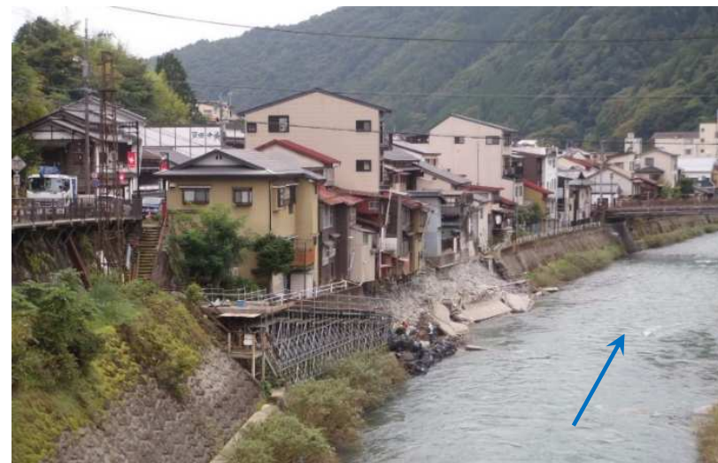
令和3年8月の大雨により 護岸基礎が崩れ、護岸に沿って並ぶ家屋12棟で倒壊のおそれ
