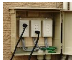
非常用コンセント
