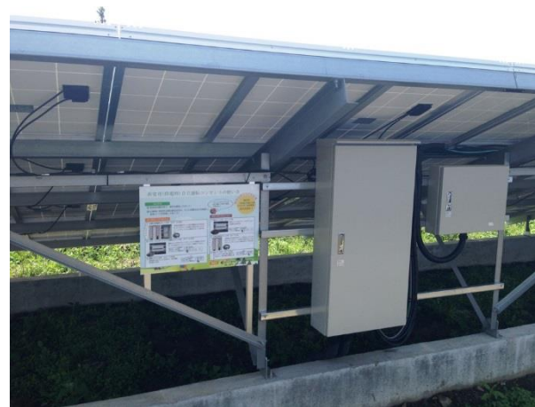
非常用コンセントの説明版
