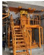
浅川第四排水機場 排水ポンプ 2026.3完成
