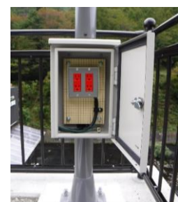
非常用コンセント
