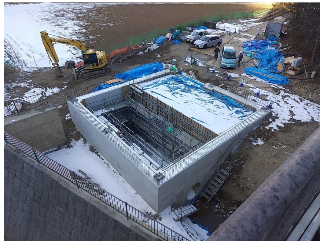
発電所の状況
