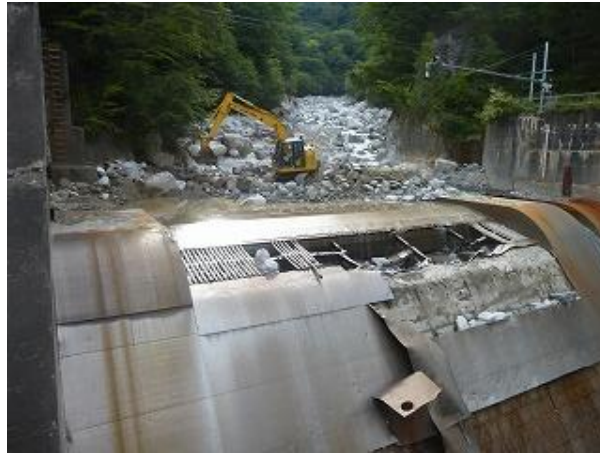
図-2.2 与田切取水口 えん堤被災状況
