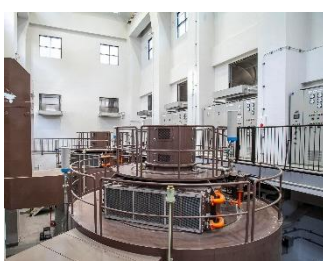
リニューアルされた発電機 （出力 25,600kW 2,000kW 増）
