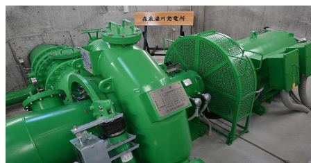
発電所内部の様子
