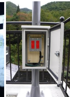
非常用コンセント(右)
