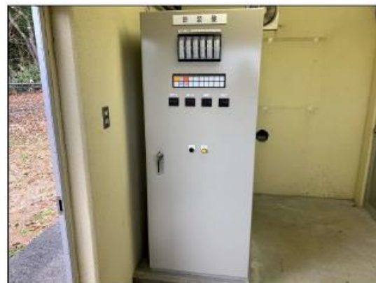
位置： 平第1配水池 撮影日： 令和元年11月28日 計装盤
