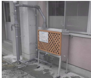
雨水貯留タンク (長野商業高校)
