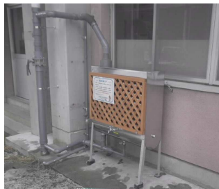
雨水貯留タンク (長野商業高校)
