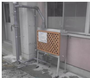
雨水貯留タンク (長野商業高校)
