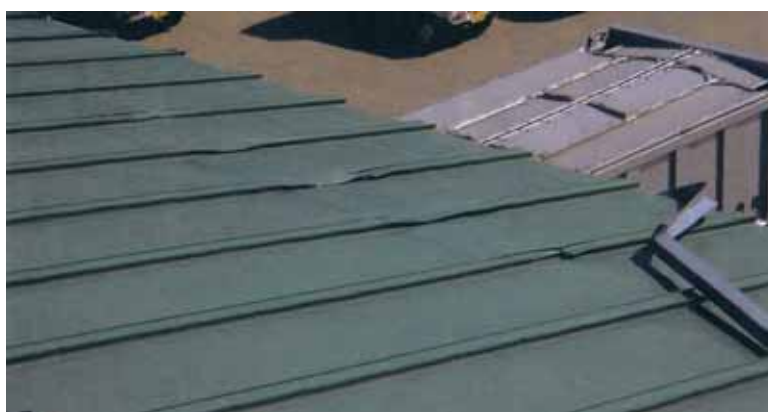
平成18年豪雪における被害例 曲がって折れた雪止めアングルと、破損した取付け部分の瓦棒
