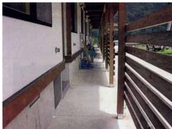
建物の前面に空間を設けた例 玄関まで直接雪が積るのを防ぎ通路にもなる
