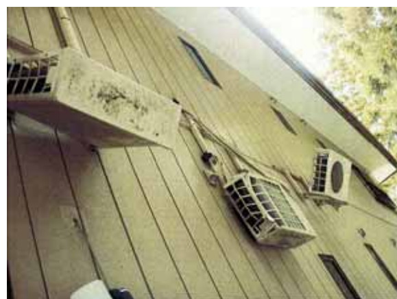
2階まで降り積もった雪の雪解けと ともに破壊されたエアコン室外機
