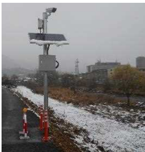
簡易型河川監視カメラ
