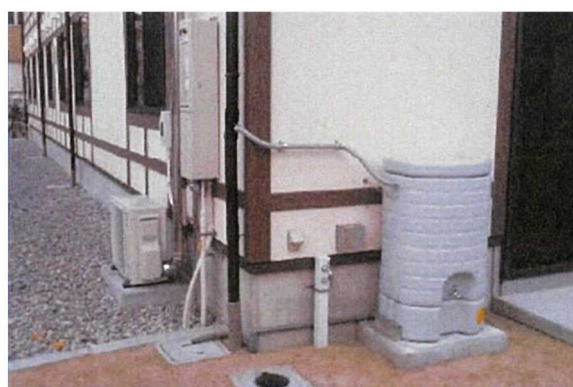
雨水貯留タンク（兵庫県 HP）
