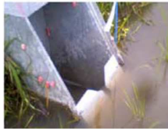
水田排水口の調整装置 設置例
