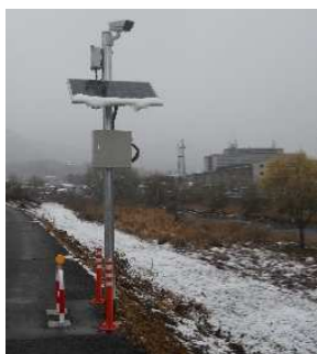
簡易型 河川監視カメラ
