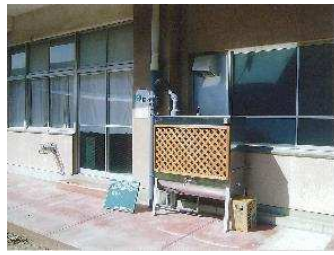
雨水貯留タンク設置例
