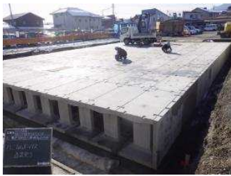
雨水貯留施設設置例 (長野市豊野支所)
