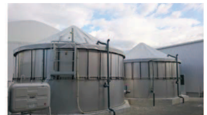
バイオガス発電 中野市
