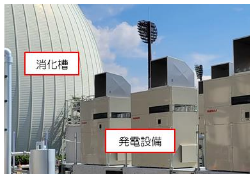
発電設備 （設備容量：300kW（25kW×12台））
