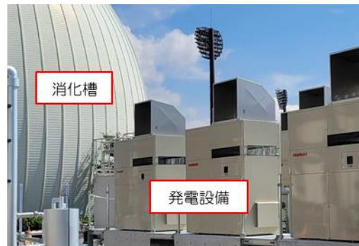
発電設備 （設備容量：300kW（25kW×12台））
