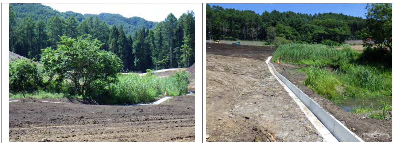
写真4-14：サクラソウ自生地への濁水流入防止対策としての排水路設置状況（令和6年8月1日撮影）
