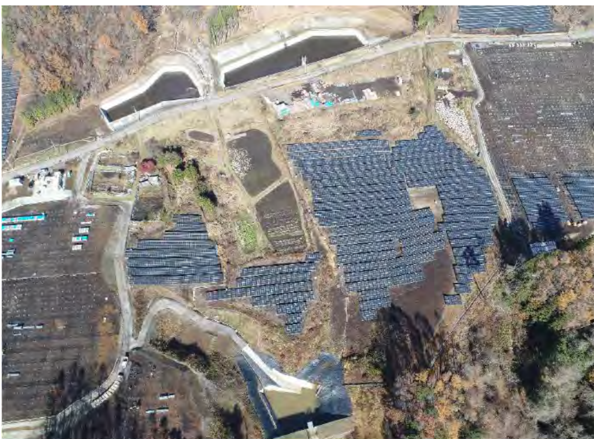
写真3-2(4) 工事の進捗状況写真 (⑥ No.6調整池まわり：令和6年11月30日時点)
