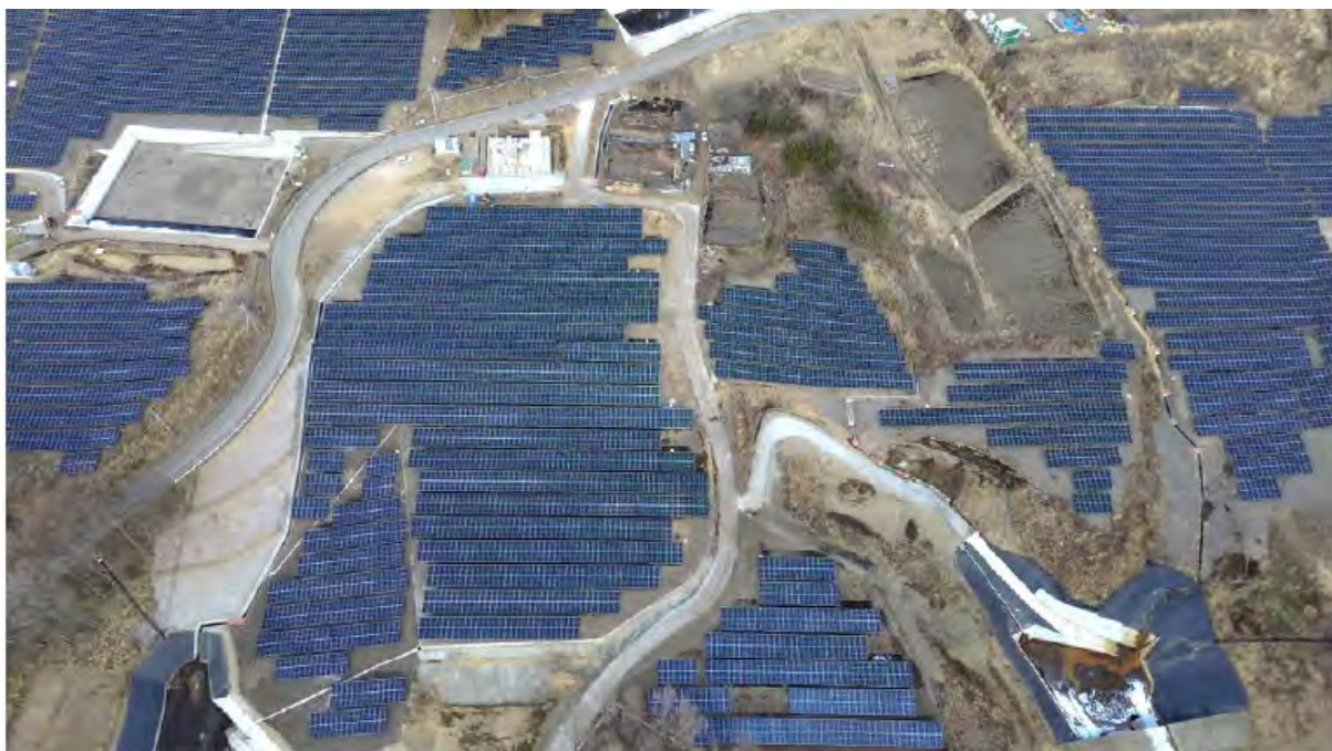
写真3-2(3) 工事の進捗状況写真 (⑤ No.5調整池まわり：令和6年12月31日時点)
