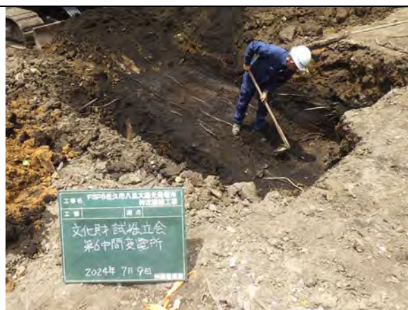
第6中間変電所
