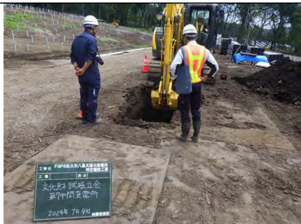
第7中間変電所
