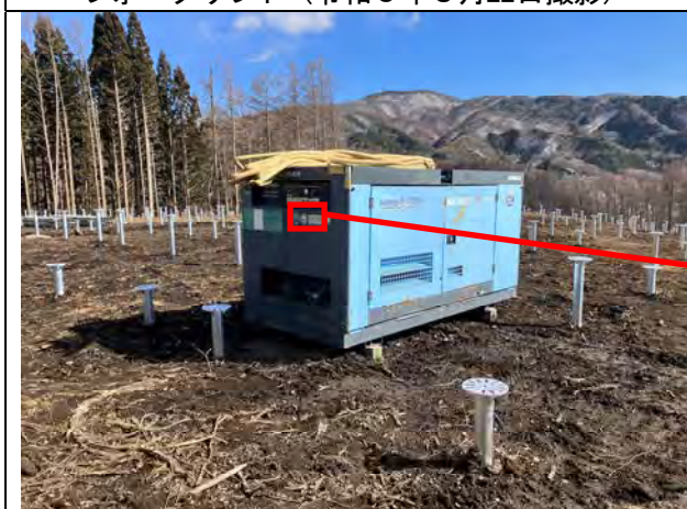
コンプレッサー（令和6年3月18日撮影）
